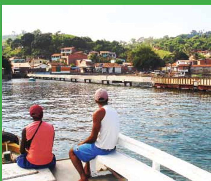
Figura 5. Atracadouro em construção, Santana, Ilha de Maré, 24/09/2010. Fotografia: Rosiléia Oliveira de Almeida.
